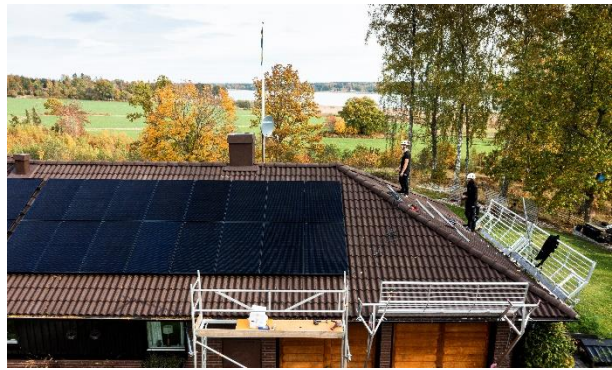
Paret har solceller på sitt hustak. Foto: Ingemar Carlström
